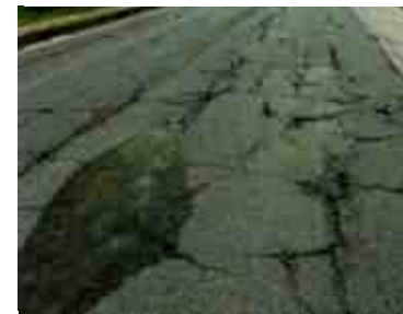
アスファルト舗装ひび割れ
