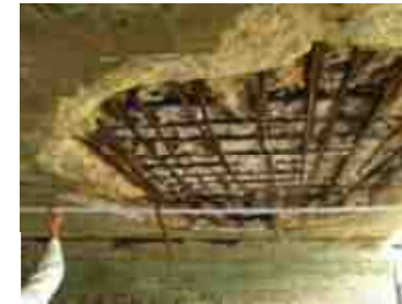
床版鉄筋露出
