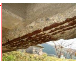
主桁の剥離、鉄筋露出
