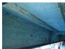
桁の塗装劣化やさびの発生
