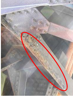
耐候性鋼材に層状の剥離
