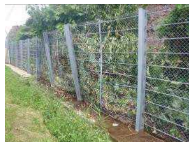
写真 落石防護柵の傾動の例
