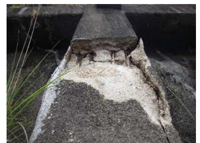
法枠工の老朽化損傷
