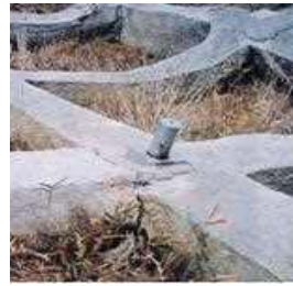
写真 受圧構造物の破損の例
