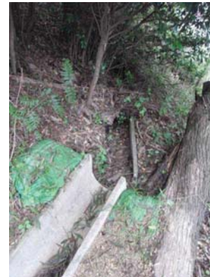
写真 排水溝の破損の例
