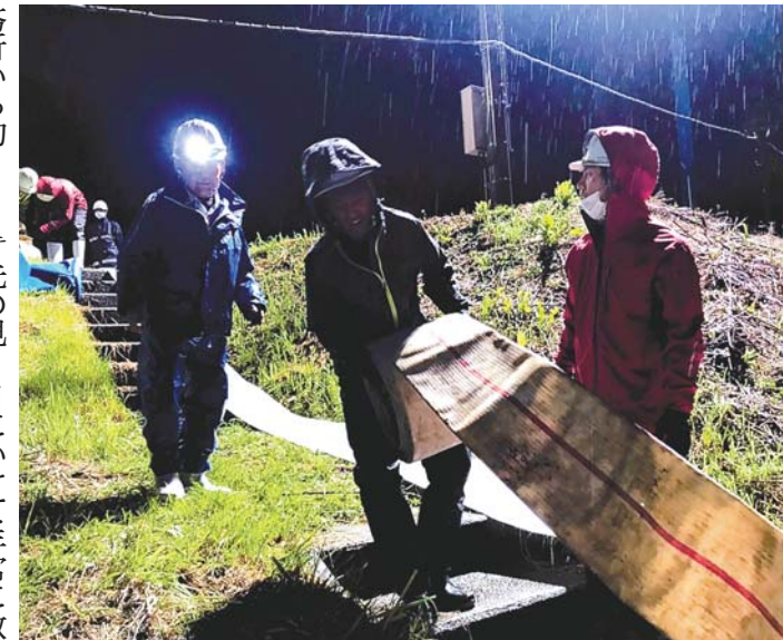
夜間、激しい雨の中で、排水ポンプを据え付ける(7月9日、福岡県朝倉市内)
