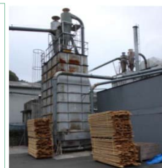
▲木質バイオマスボイラー
