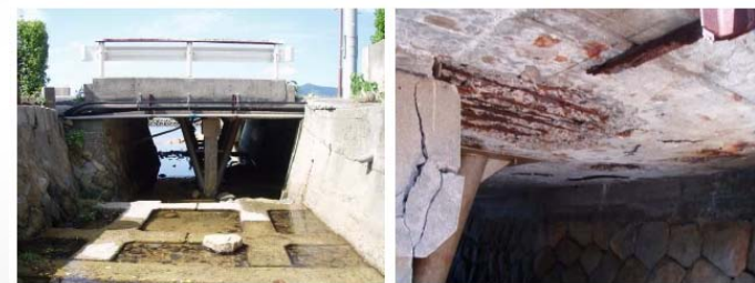
▲RC 床版の塩害等による損傷事例
