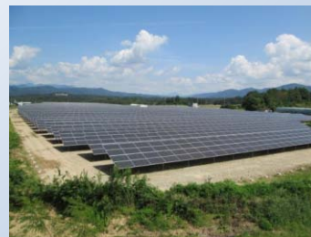
▲庄原太陽光発電所
