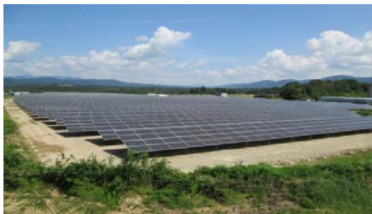
▲庄原太陽光発電所
