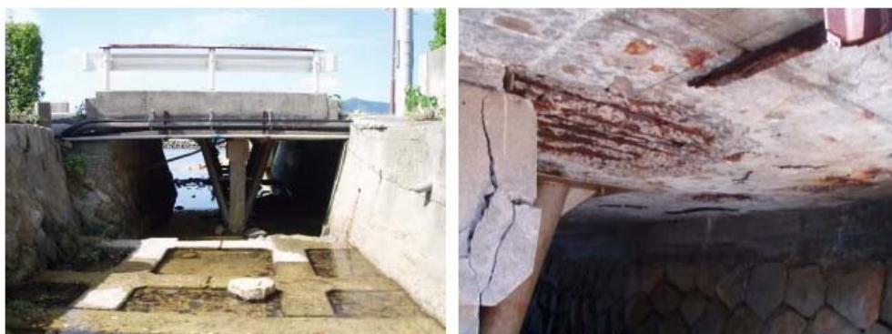
▲RC 床版の塩害等による損傷事例
