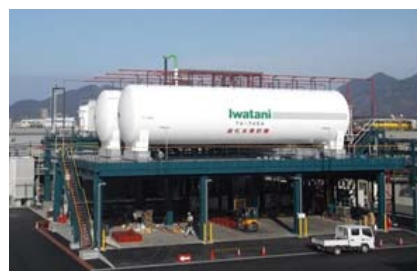
▲液化水素製造プラント
