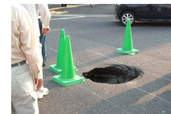
老朽化した下水道管腐食に起因する道路陥没状況 (広島市中区舟入南) 出典：広島市
