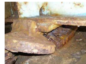
鋼製支承の損傷 (国道29号 須澄橋)
