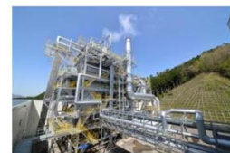
平成27年4月に稼動したバイオマス発電所
