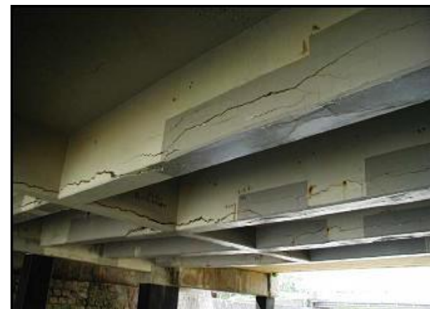
➤ 断面修復箇所の再劣化
