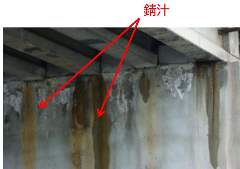
➤ 漏水・遊離石灰
