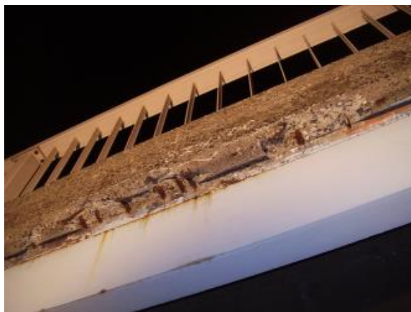
➤ 張出し部の剥離・鉄筋露出
