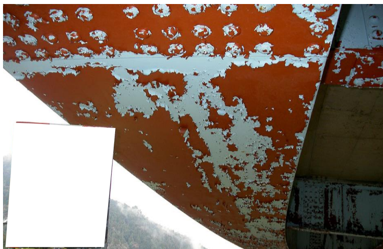
➤ 塗膜の劣化(防食機能の低下)
