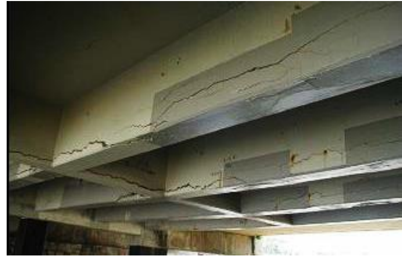
➤ 断面修復箇所の再劣化
