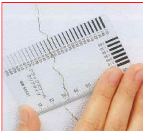
クラックスケールの計測例
