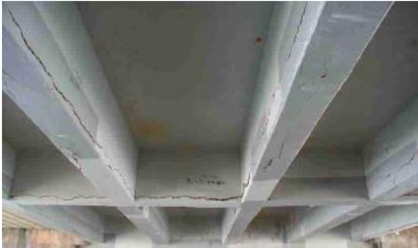
➤ 断面修復箇所の再劣化
