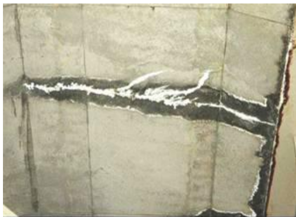
➤ 漏水・遊離石灰
