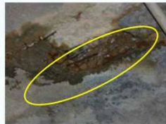
覆工コンクリートの剥落・貫通びひ割れ
