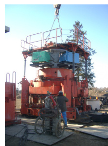
写真-4 油圧ユニット
