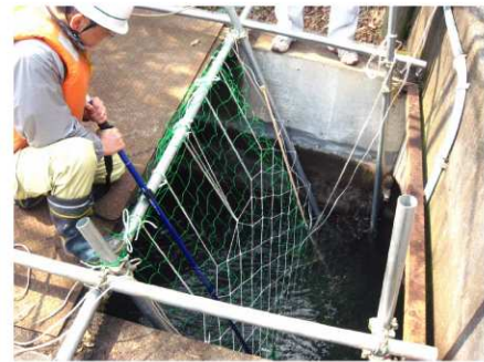
写真－4 下流側捕捉ネット
