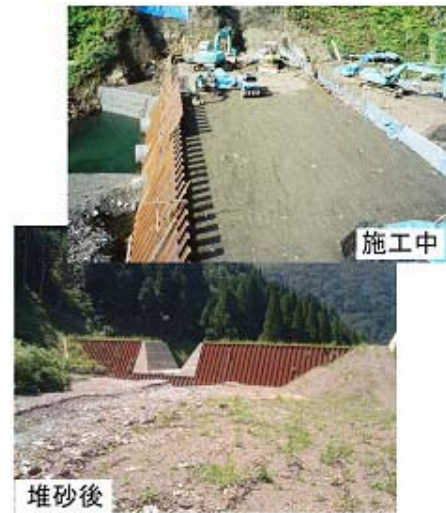
写真9 現地土砂の利用と施工直後の台風により満砂したえん堤
