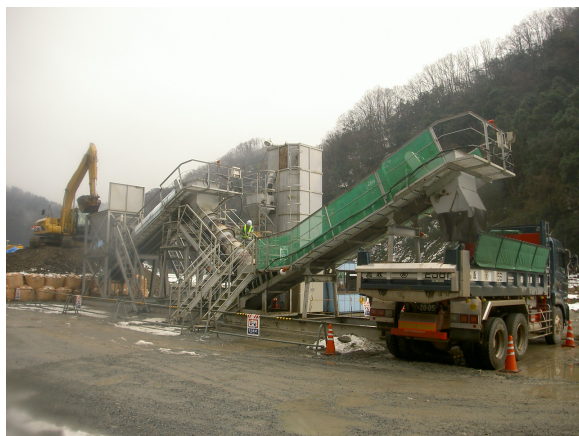
写真①：簡易プラントミキサーによるCSGコンクリート製造状況
