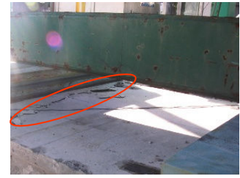
写真-2 破壊状況
