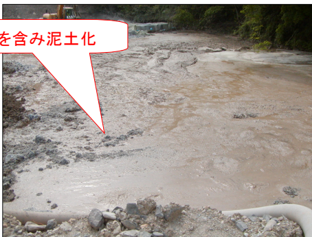
写真①：掘削現場の泥土化状況
