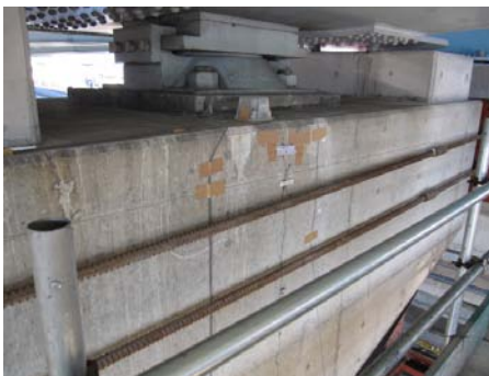
写真-22 一期線の下部工の損傷状況
