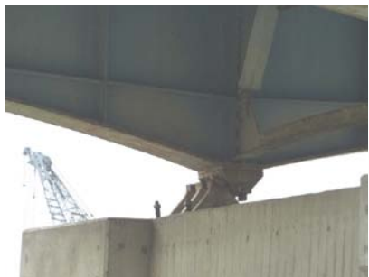
写真-16 同上の中間支点部の沓の損傷
