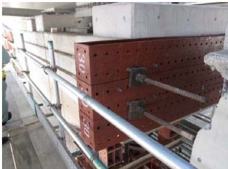
写真-23 下部工の応急処置状況
