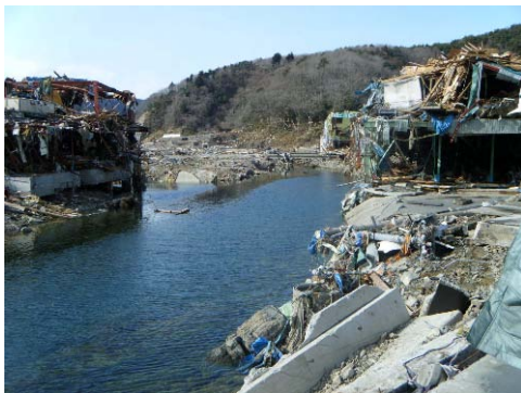
写真四 流出した鋼橋(女川橋)
