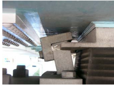
写真-24 二期線のゴム支承の損傷（L側）
