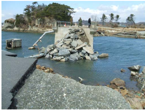
写真二 落橋したPC橋(松ヶ島橋)
