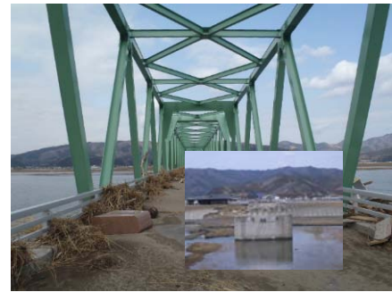
写真六 トラス橋の被害(一部流出) (新北上大橋)
