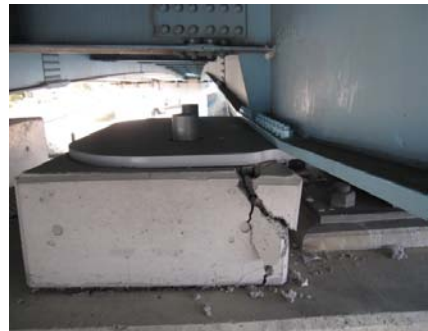
写真-25 変位制限装置の損傷
