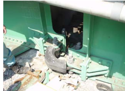
写真-20 支承の破壊と落橋防止装置
