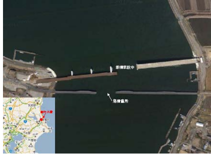
写真-14 地震による被害(鹿行(ろっこう)大橋)
