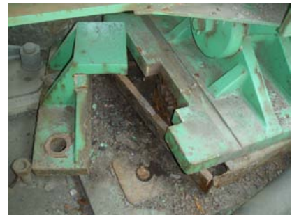
写真-18 同橋梁の支承の損傷状況
