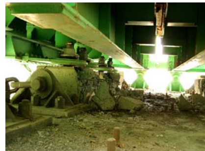
写真-19 同橋梁の変位制限装置の破損
