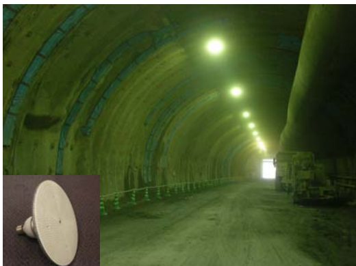
写真4 坑内LED照明
