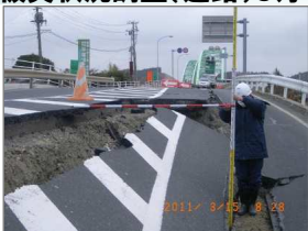
3/14(月) 国道45号被害状況調査(道路班)
