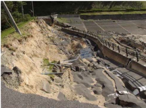
写真4 福島県 藤沼貯水池の被災状況
