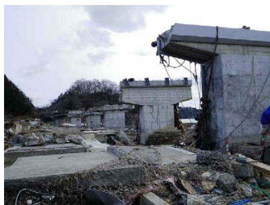
写真-2 道路橋の津波による桁の落下の状況 国道45号 南三陸地区 歌津大橋
