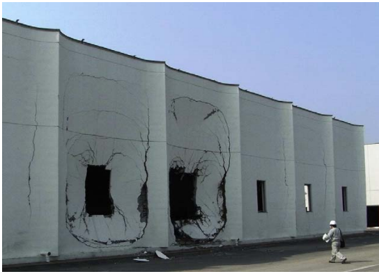
写真3 南蒲生ポンプ場の津波による被災状況
