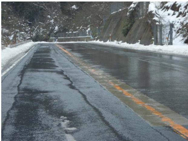
写真-2 散水式消雪工の様子
