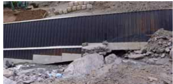
写-2 洗掘を受けたINSEM材を用いた導流堤
