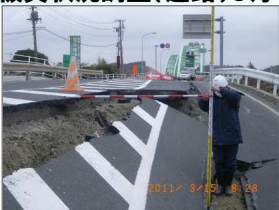
3/14(月) 国道45号被害状況調査(道路班)
