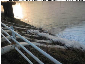
女川排水機場(石巻市)における排水ポンプ車稼働状況
