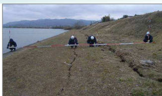
3/16(水) 旧北上川被害状況調査(河川班)
