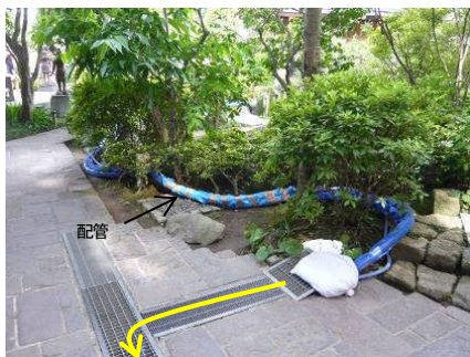
写真-4 境内内の配管状況
