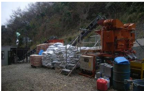
写真-1 モルタル製造プラント全景
