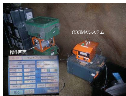
写真-6 COGMAシステム配置状況
