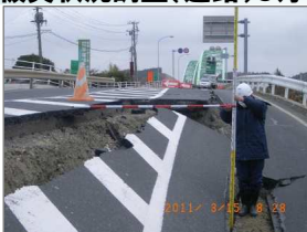
3/14(月) 国道45号被害状況調査(道路班)
