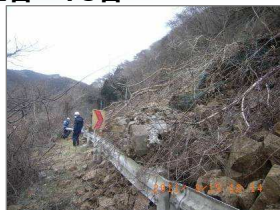
3/14(月) 国道被害状況調査、迂回路調査(道路班)
