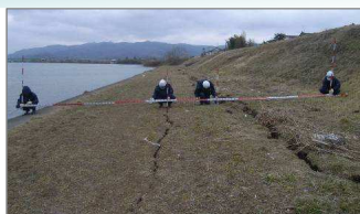
3/16(水) 旧北上川被害状況調査(河川班)
