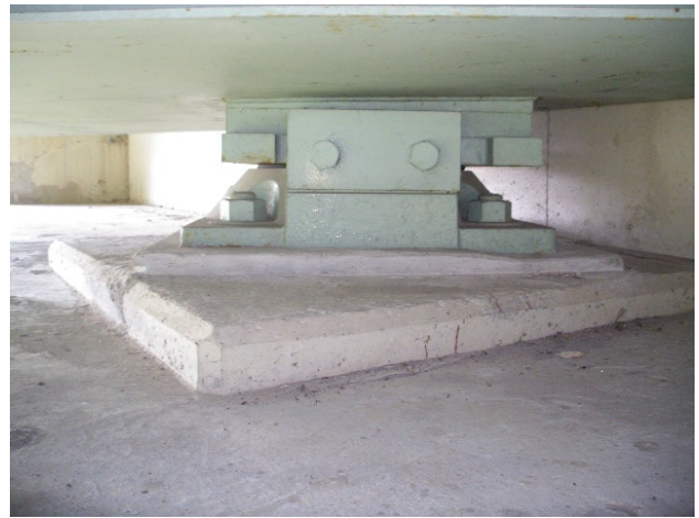
写真－14 水（湿気）による腐食防止及び維持管理の作業性確保を行っている橋梁例（橋座部）
