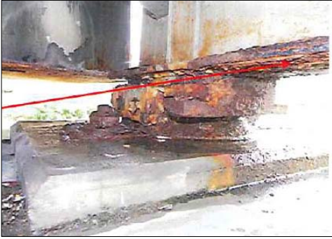
写真-2 伸縮装置部 (著しく腐食)
