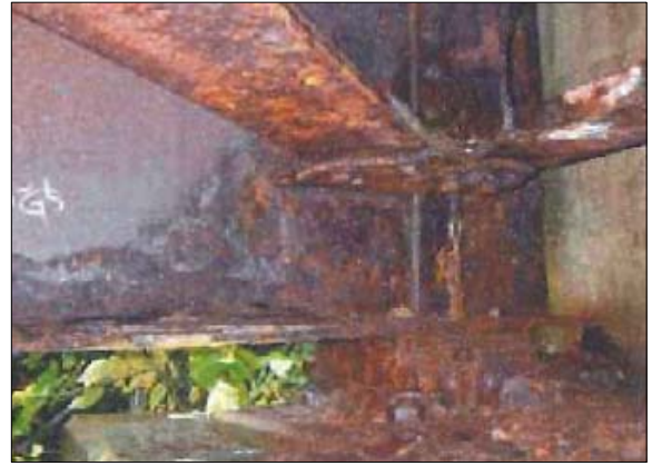
写真-11 耐候性鋼材の腐食状況
