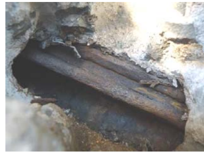
写真-3 PC 鋼材の腐食状況
