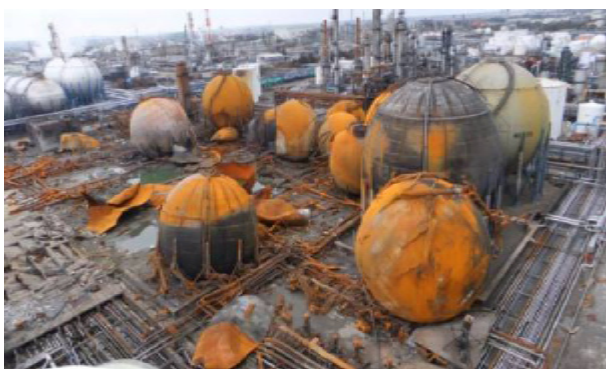
図-1 東日本大震災での東京湾臨海部におけるLNGタンク被災 1)
