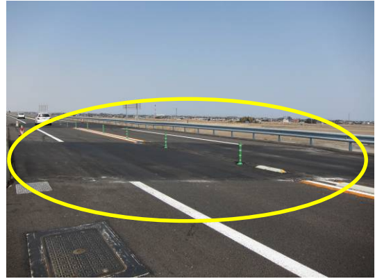
写真-15 周辺橋梁部の舗装補修跡
