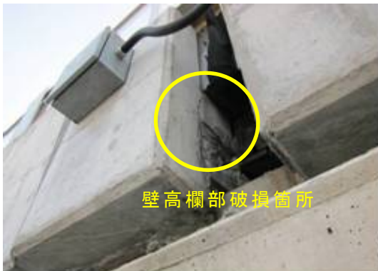
写真-8 壁高欄破損箇所
