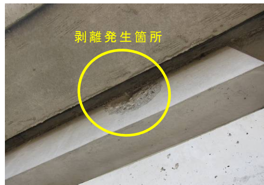
写真-11 底版側面剥離箇所
