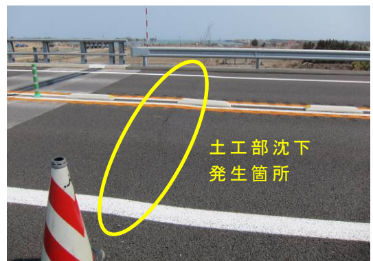
写真-10 鏡川橋沈下発生箇所
