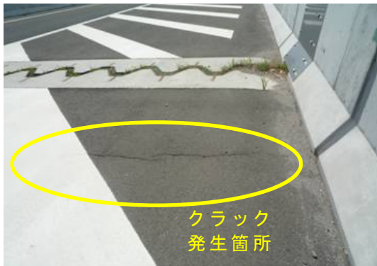
写真-13 クラック発生箇所
