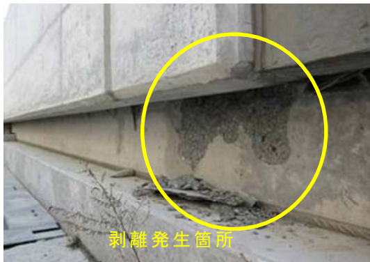
写真-14 底版側面剥離発生箇所
