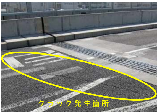
写真-7 クラック発生箇所 (A2 橋台)
