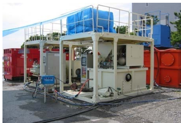
写真-2 高圧ポンプおよび研磨材スラリープラント
