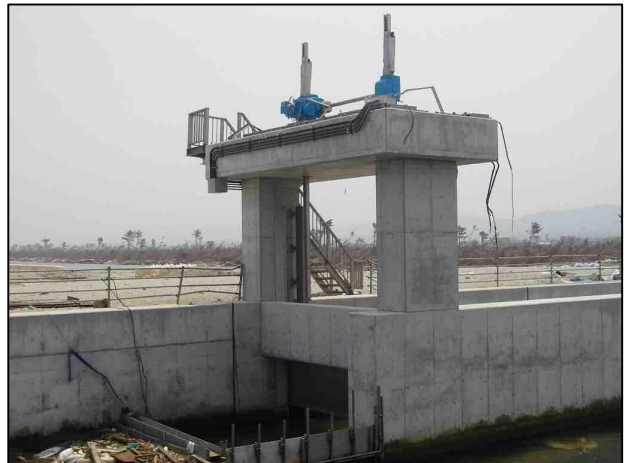
図-5 周辺が損傷した開閉機全景（山元町）
