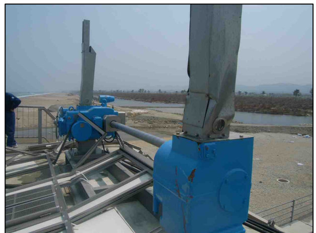
図-6 周辺が損傷した開閉機（山元町）
