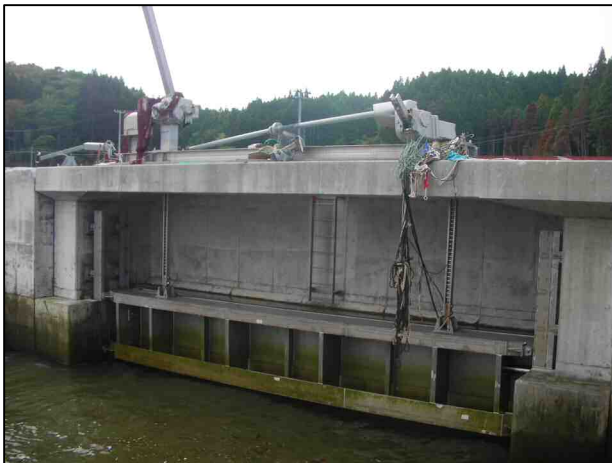
図-3 全損した開閉機全景（南三陸町）
