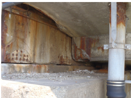
写真-1 桁端損傷例
