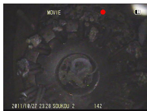
写真-11 PC定着部露出状況
