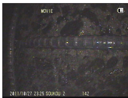
写真-10 鉄筋露出状況
