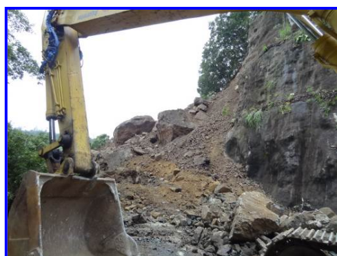
図-12.2 現場状況写真【2015/7/23撮影】
