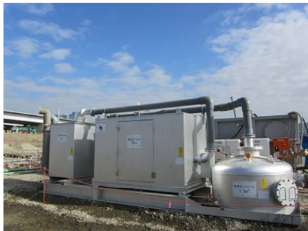
写真-3 排ガス処理装置
