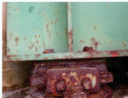
支承に機能異常あり 判定区分: II～III
