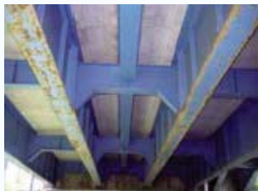
下フランジに腐食あり 判定区分: OK～IV
