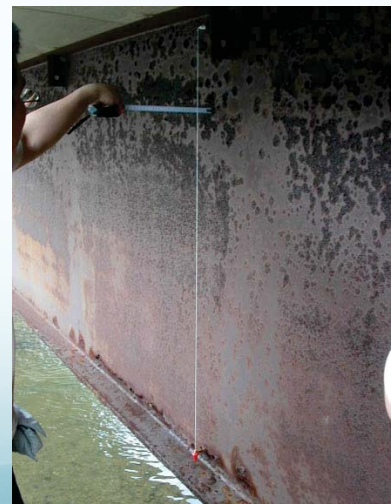
腹板・下フランジ断絶
