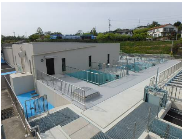
写真-6 急速ろ過池および制御盤室
