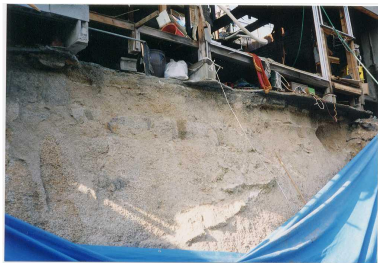
呉市両城2丁目の石積み擁壁の崩壊面
