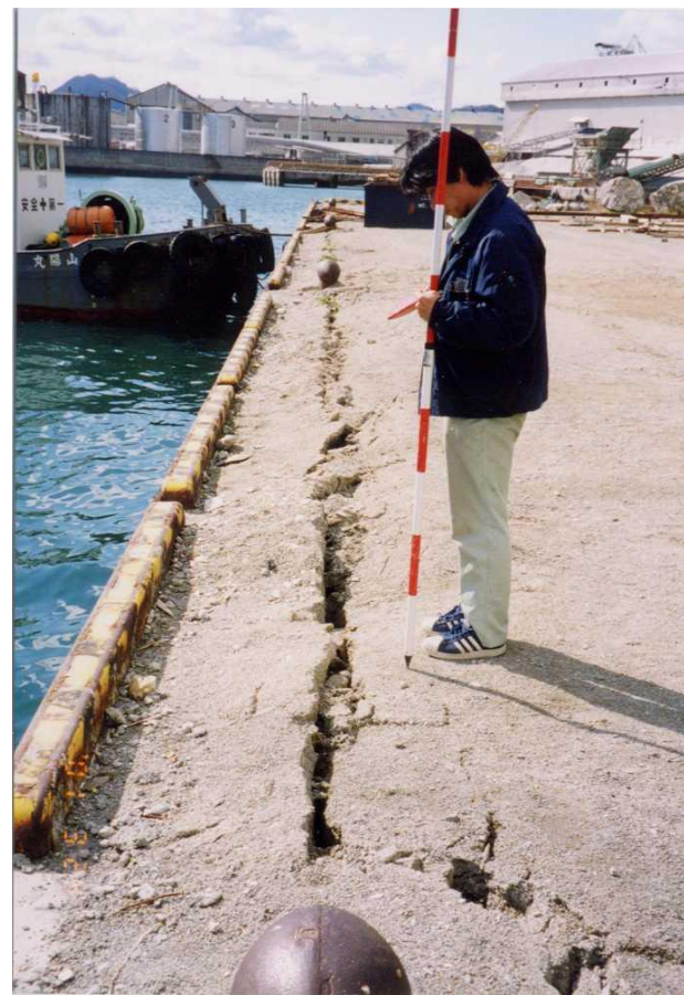
三原市糸崎港における岸壁の変状
