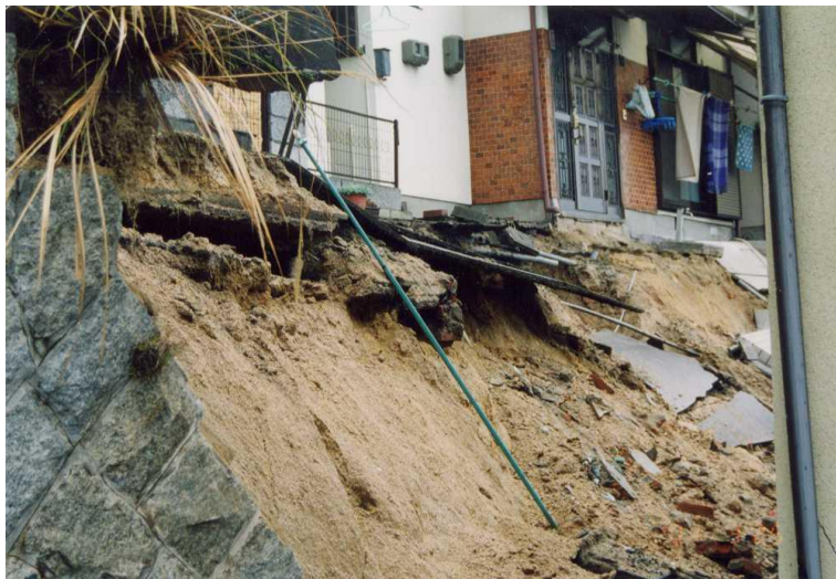
呉市片山地区の石積み擁壁の崩壊
