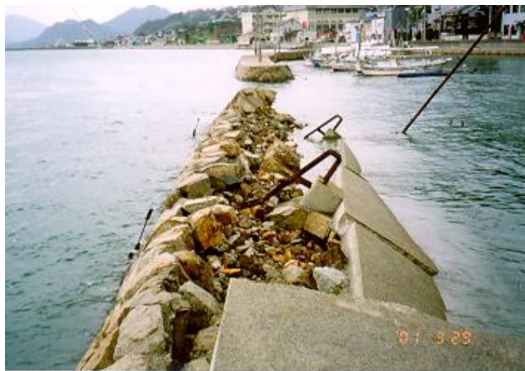
三原市須波漁港における石積み防波堤の崩壊
