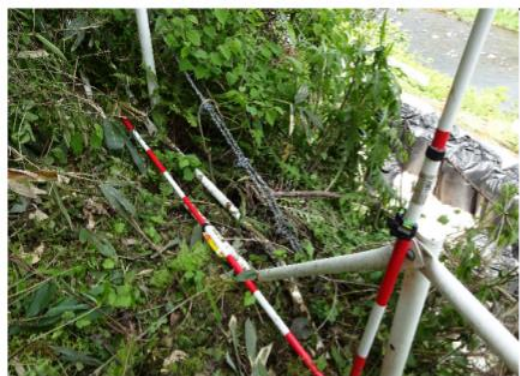
落石痕 (ガードパイプ)
