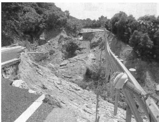
図-4 広島県道路における盛土の崩壊
