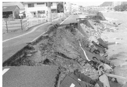
図一11 広島市安芸区中野東における国道2号の陥没 (中国地方整備局広島国道事務所提供)
