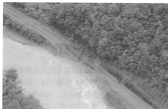
図一14 本郷～河内駅間沼田川の増水による盛土陥没
