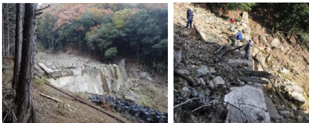
(a) 治山ダムの外観 (b) 治山ダムの被災状況
