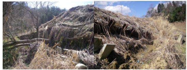
写真-13 被災状況（既設擁壁崩壊）
