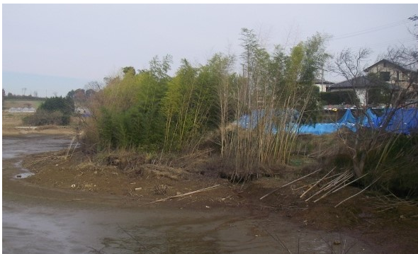
写真-11 ため池法面崩壊状況
