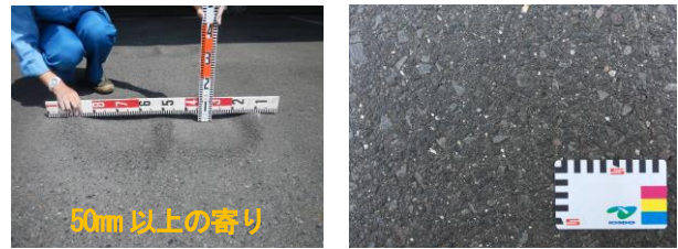
写真-7 改修前の状況 写真-8 供用2年3ヶ月後の路面
