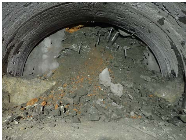
図-2 切羽崩落状況（TD=750m付近）
