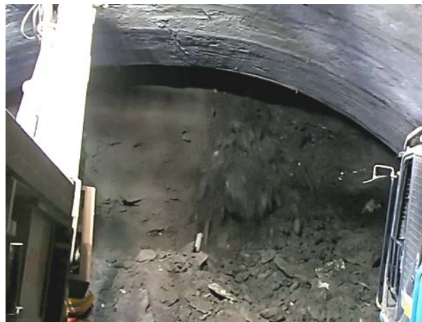
図-3 切羽崩落状況（TD=760m付）
