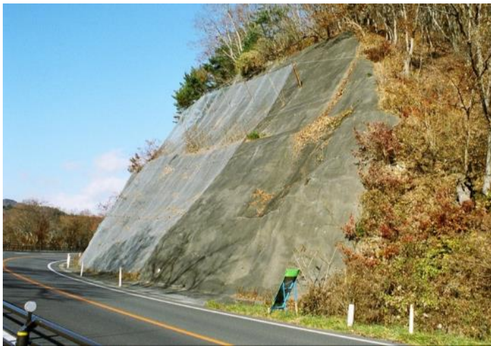
老朽化吹付法面
