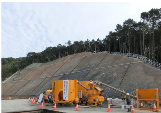
写真-1 「Automatic-Shot R」プラント全景
