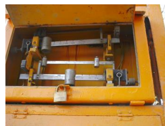
写真-5 バッチャースケール
