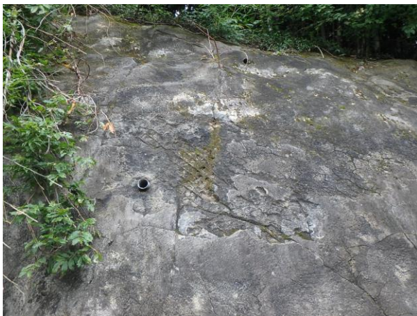
写真-4 既設法面工の状況
