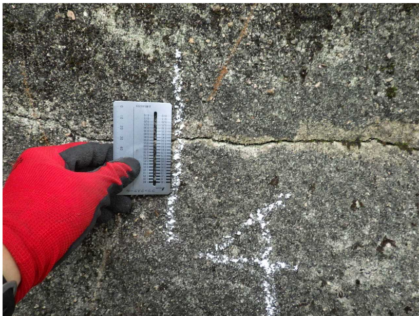
モルタル吹付に発生したひび割れ
