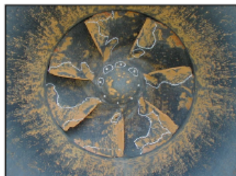
腐食した排水ポンプ場の羽根車
