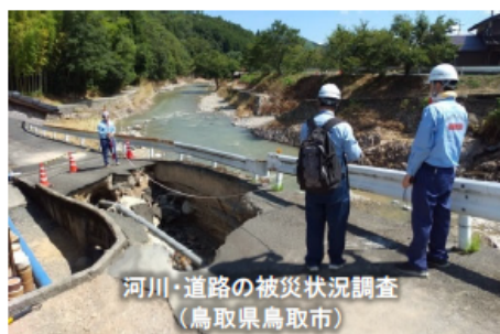
【令和5年台風7号による大雨】
