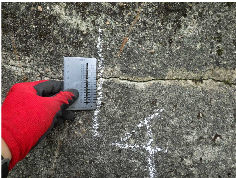
モルタル吹付に発生したひび割れ
