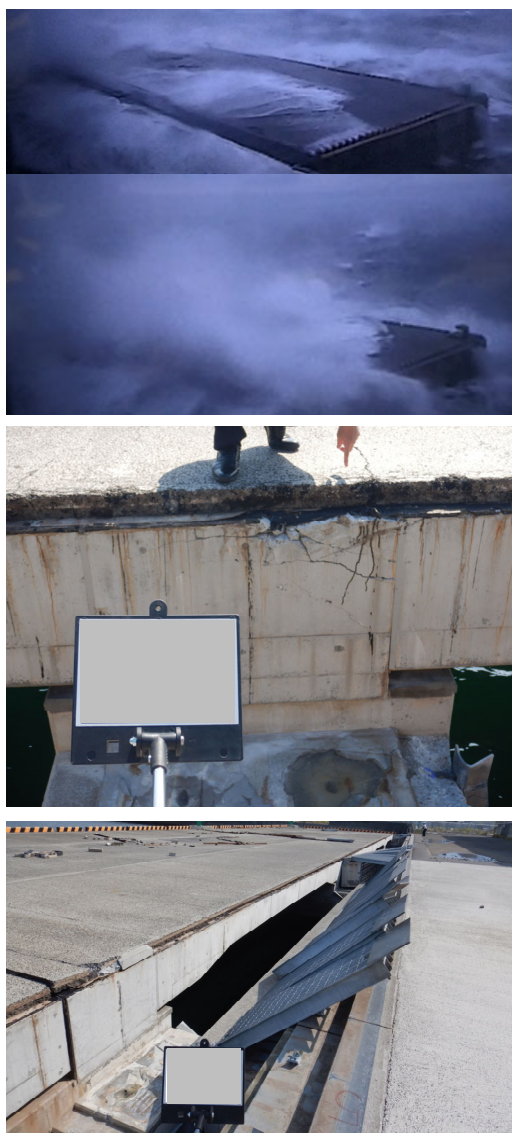
写真-5 栈橋の被災状況
